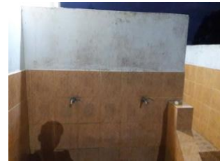
Gambar 7. Ketersediaan jaringan air bersih di NDA-L Sumber: Dokumentasi penelitian
