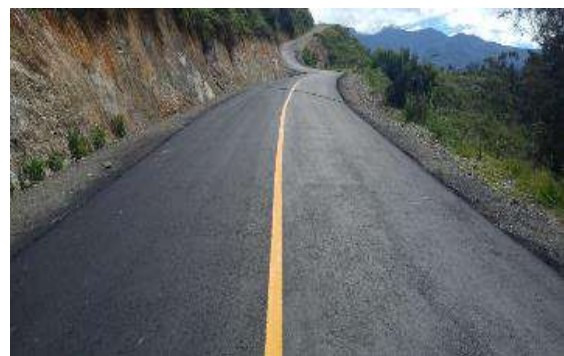
Gambar 5.c. Kondisi jalan Mulia-Sinak km 194 pada tahun anggaran 2021
