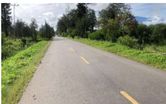
Gambar 5.a. Kondisi jalan Wamena-Mulia km 17 pada tahun anggaran 2021
