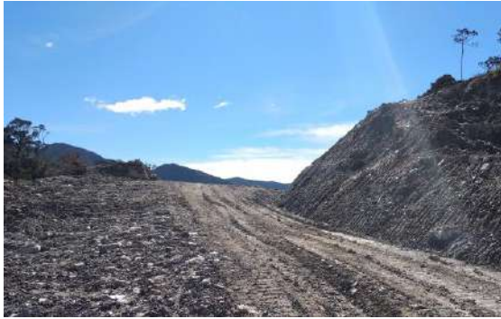
Gambar 4. Kondisi eksisting badan jalan pada ruas Wamena-Mulia-Sinak sebelum ditingkatkan.
