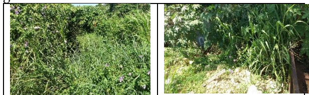
Gambar 8 Vegetasi menutupi seluruh permukaan Drainase
